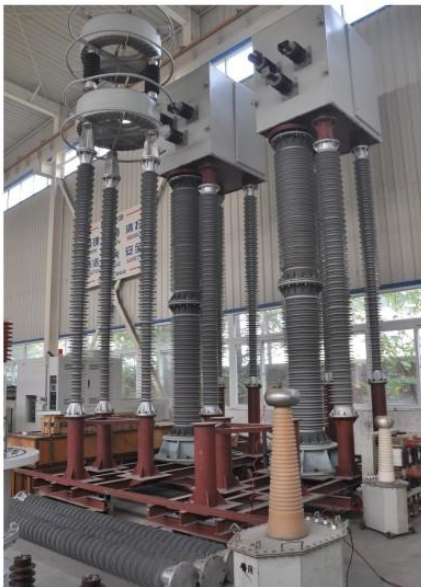
330kV限流器实验室
