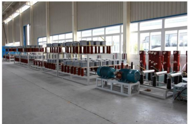
双电源切换实验室
